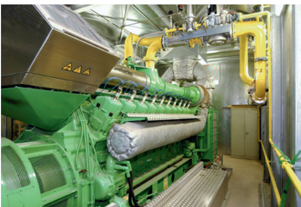
Einblick in die Strom- und Wärmeproduktion
