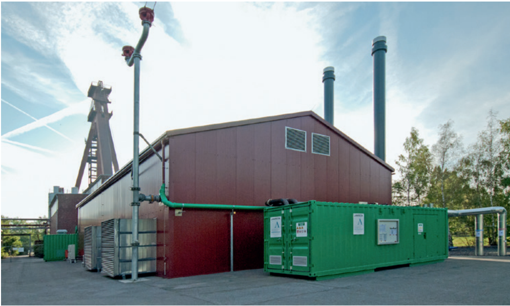
Auf Grillo 1 sind die Gas-Motor-Aggregate in einer Lärmschutzhalle untergebracht
